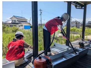
津波がきた家の掃除をしている様子
